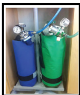
Figura 5: Foto ilustrativa do armazenamento dos gases (N 2 O/ O 2 ).
