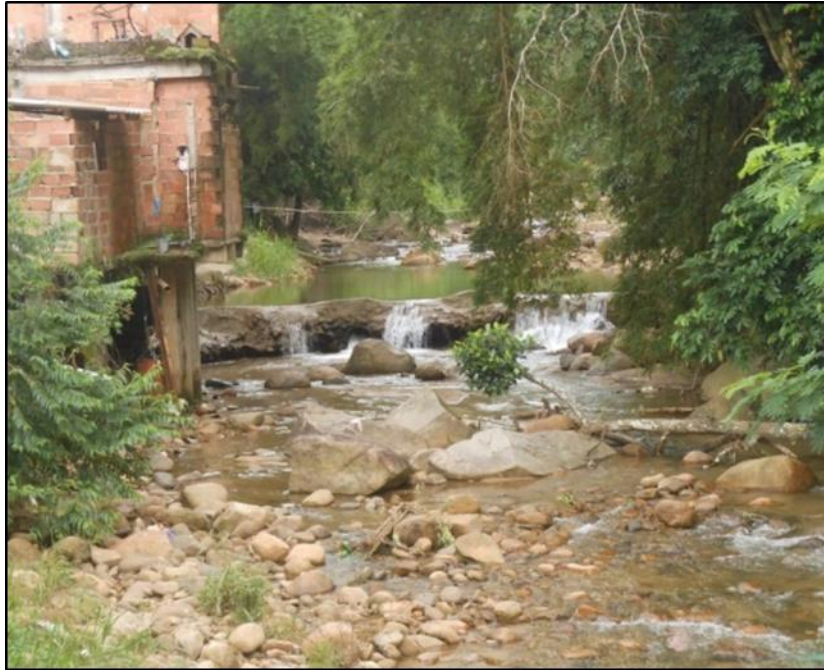
Figura 6: vista geral do curso do trecho do Rio Soberbo em Guapimirim. Observar a fundação das casas diretamente assentadas em material heterogêneo e instável.
