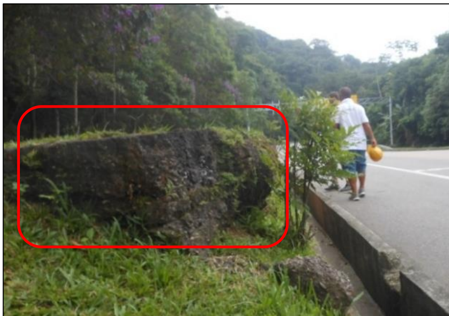
Figura 5: Foto do trecho da BR-116 próximo à Vila Guapi, mostrando em destaque o antigo trecho da rodovia, abandonado devido à movimentação da língua de colúvio.
