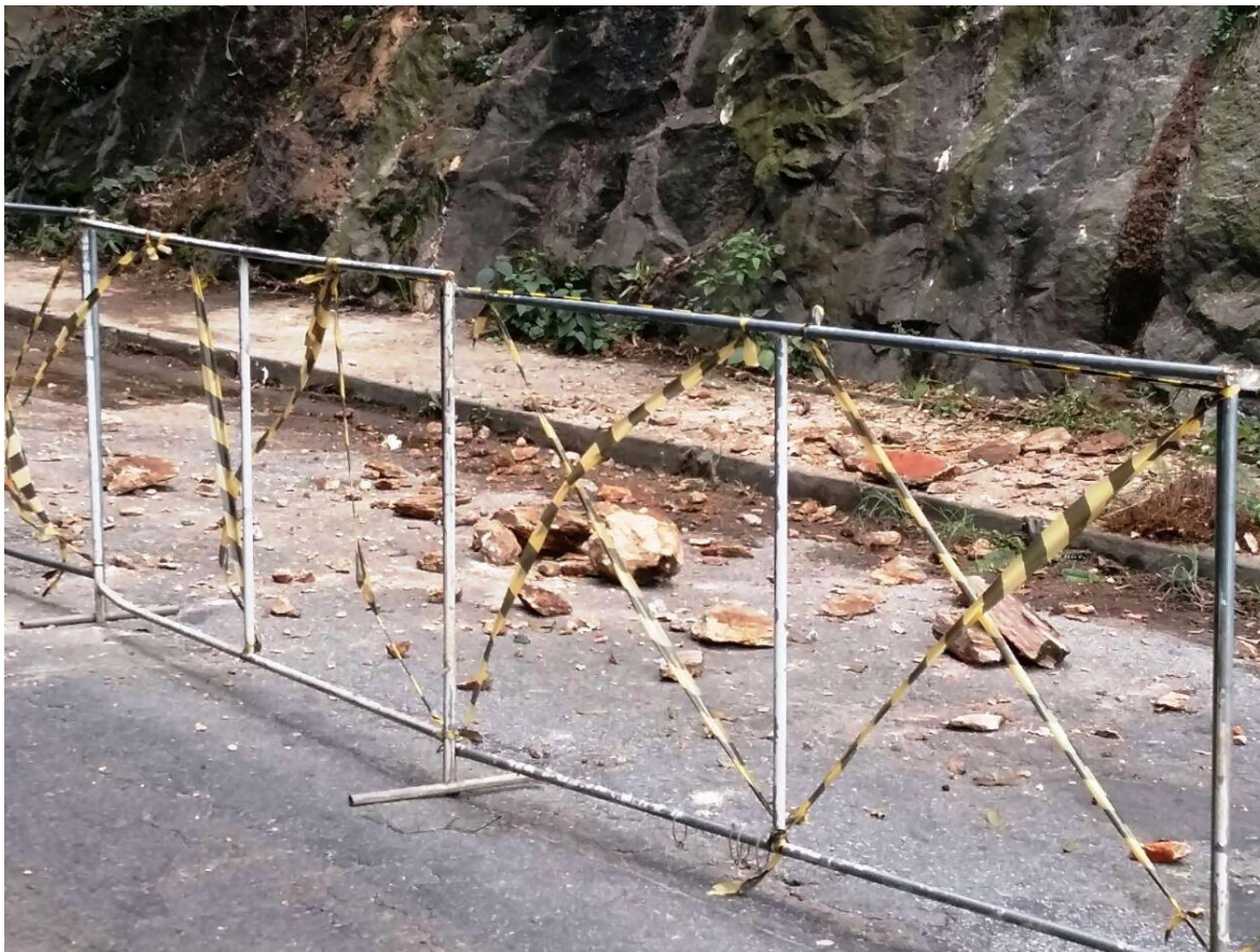
Figura 3: Detalhe dos fragmentos rochosos quedados sobre a pista e da interdição da mesma.
