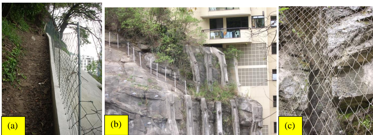
Figura 6: (a) cinta chumbada junto à crista do talude e revestimento com concreto projetado; (b) fixação de blocos rochosos instáveis com chumbadores e contrafortes; (c) revestimento com tela de alta resistência, principalmente na parte mais fraturada do talude. Fotografias: arquivo do autor.
