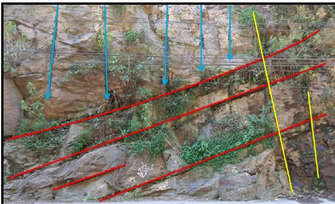
Figura 5: Padrão de Compartimentação Estrutural do Corte da Barra. Observe a formação de blocos rochosos instáveis em função da combinação e da superposição de fraturas tectônicas (em amarelo), de alívio (em vermelho) e de fogo com explosivos (setas em azul). Adaptado de Ribeiro (2017).
