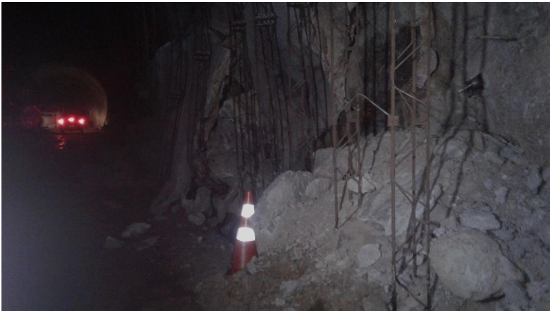
Figura 3: Deslizamento de lasca na parede do túnel. (Fonte: Tenorio, 2018).
