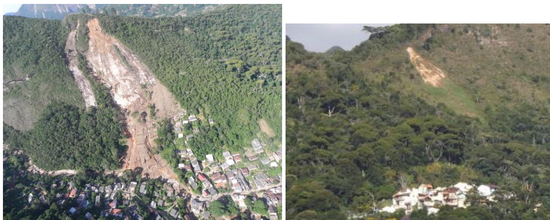
Figuras 3: Deslizamentos na “Parroca”. a) Caleme, Megadesastre de 2011. b) encosta do bairro Iúcas, em Fev/Mar2016. O seu alcance só não foi maior porque o volume de material mobilizado ao longo da superfície de ruptura foi pequeno.
