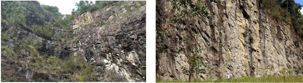
Figura 3: Afloramento de Biotita-gnaiss migmatítico com presença de muitas fraturas de alívio por toda extensão, além de sets de fraturas tectônicas subverticais de direção NE-SW e NW-SE e algumas marcas de dinamite (verticais). a) Vista frontal da pedreira; b) vista da parede lateral, evidenciando lacas de alívio.
