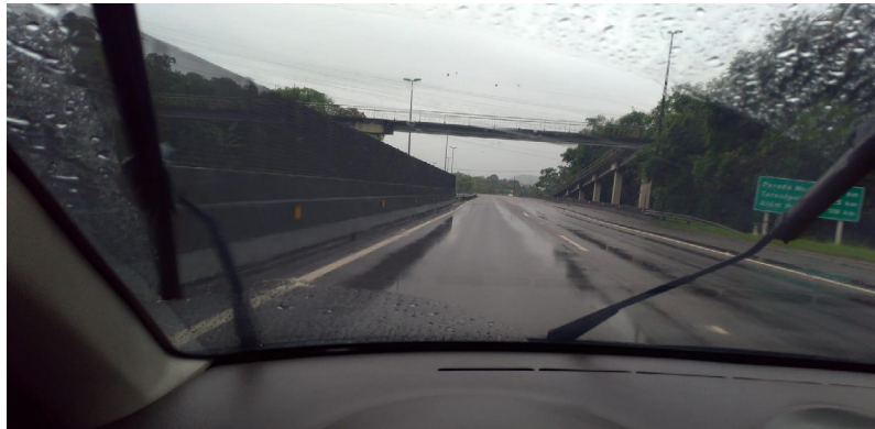
Figura 7 - Afundamento de trilha de roda devido ao tráfego – km 113
