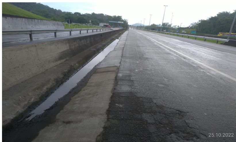
Figura 8 - Sarjeta com acúmulo de água – km 114
