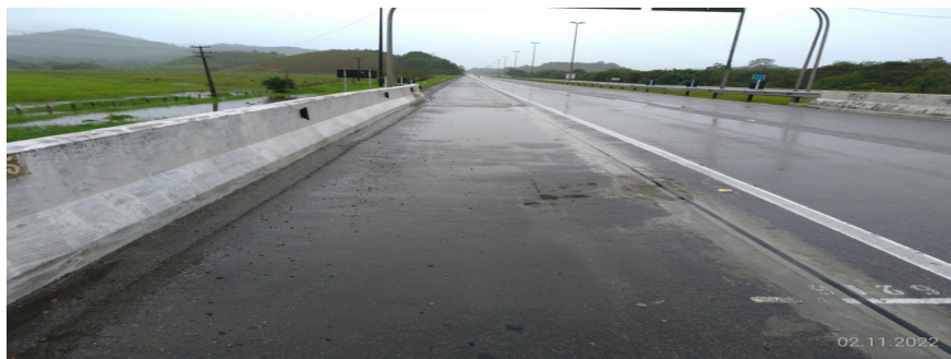
Figura 13 - Acúmulo de água no acostamento da ponte Iriri
