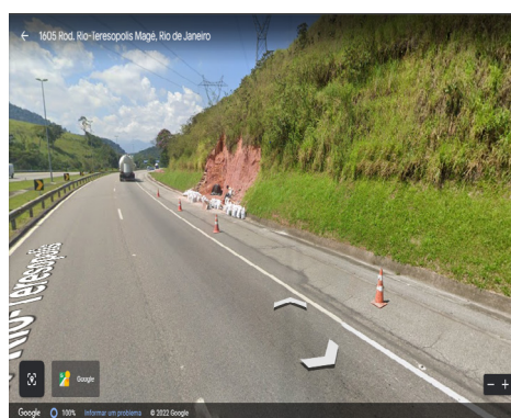
Figura 4 - Erosão no corte do talude – km 113
