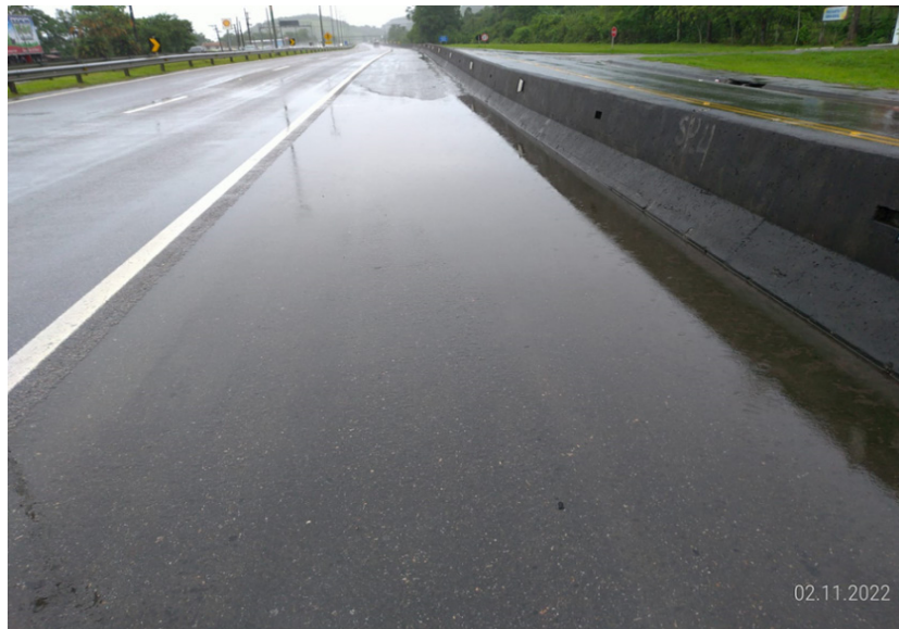
Figura 3 - Acúmulo de água no acostamento – km 106
