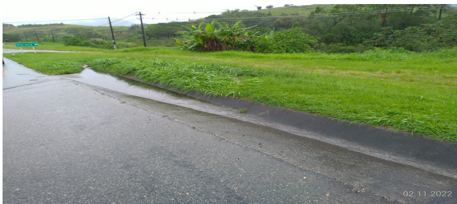
Figura 12 - Acúmulo de água em uma valeta de drenagem – km 119
