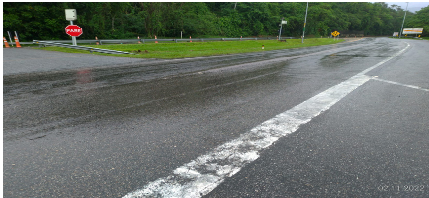
Figura 1 - acúmulo de água em declive longitudinal – km 104
