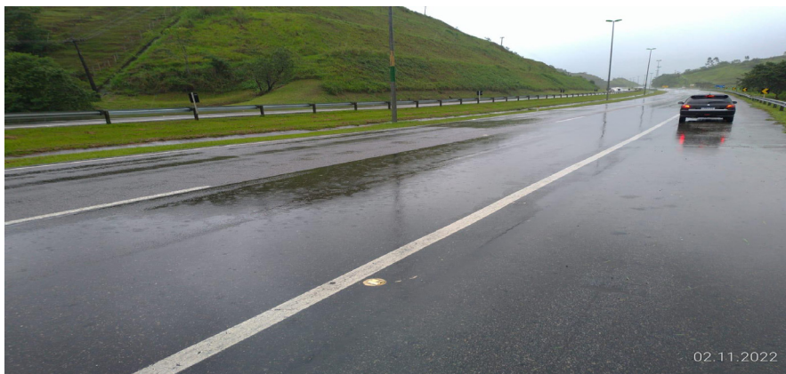
Figura 11 - Acúmulo de água na faixa externa – km 118
