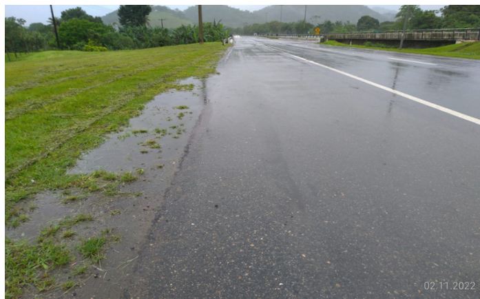
Figura 9 - Acúmulo de água no acostamento – km 116
