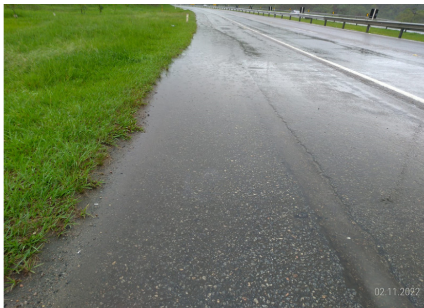
Figura 6 - Acúmulo de água no acostamento – km 113
